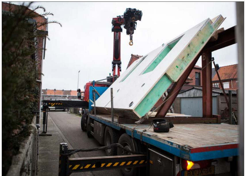
MODULE – Door met geïndustrialiseerde modules te werken, is de bouwtijd zeer kort.
